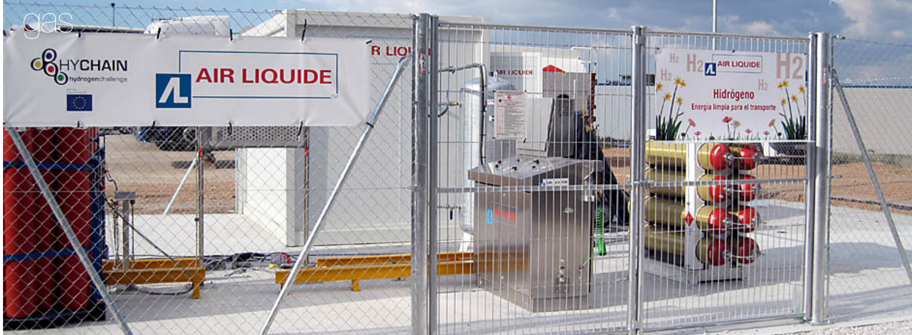
Hidrogena de Air Liquide en Soria. AIR LIQUIDE
