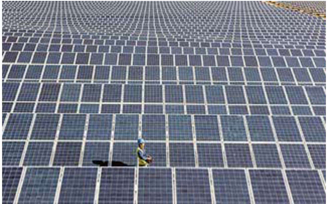
Central solar fotovoltaica de Arnedo. elEconomista
